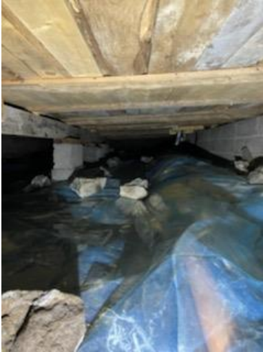
Krypgrund, Avdunstningsskydd finns på markytan.
