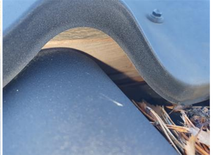
Tätning saknas mellan plåtarna.
