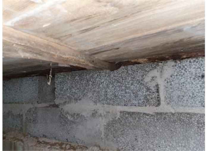
Krypgrund, sättning noteras.
